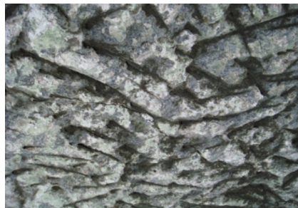
↑天井 析出物 I が見られる
