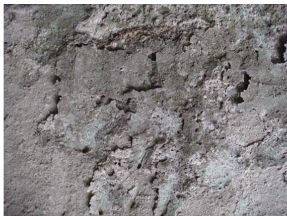
e. 右壁 表層剥離
