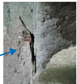
↑右壁 薄い層状の浮き上がり
