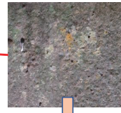
一部残っていたオレンジ色の地衣類も更に5ヶ月が経ち目立たなくなった
