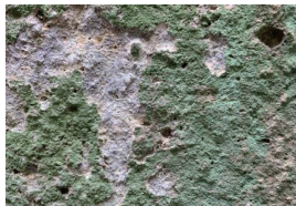
地衣類及び表面剥離が顕著
