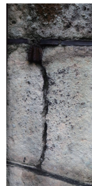
図7. 金属部から生じた亀裂
