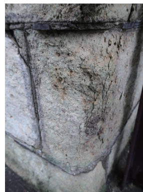
図6. 石材表面の亀裂・剥離・摩耗
